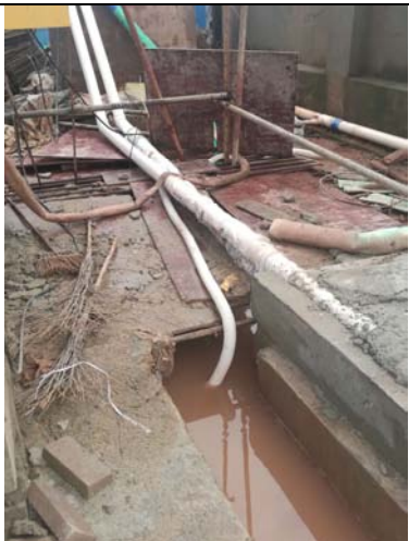
沉砂池 2016 年 3 月 28 日
